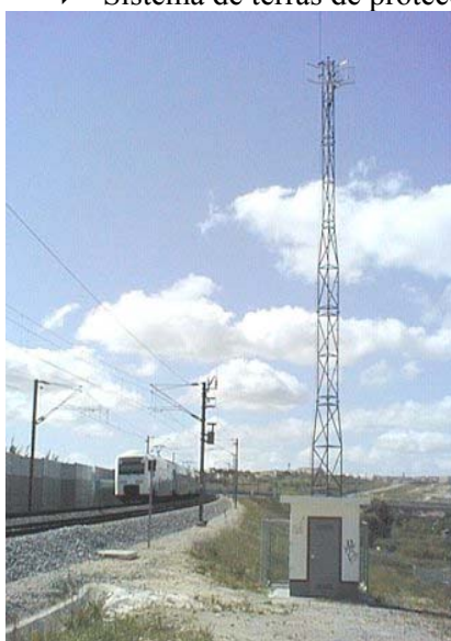
Figura 49 – Casa Abrigo, Torre e Antenas
